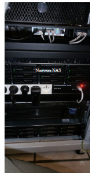
Remplacement du NAS en septembre 2017
